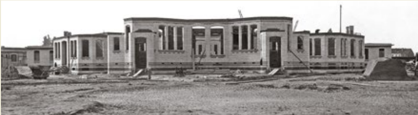
Het consultatiepaviljoen van de volwassenengeneeskunde in aanbouw, zoals het in de as van de ingang zichtbaar was.
